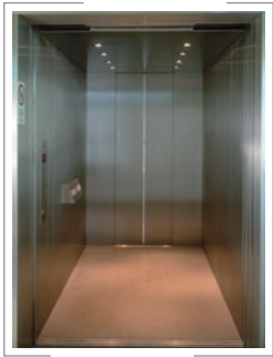
Blechkabine mit Durchladung
