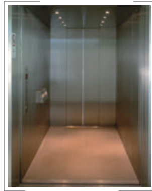
Blechkabine mit Durchladung
